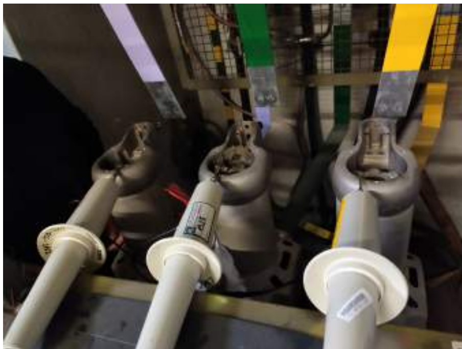
Rysunek 4.7. Widok na stanowisko badawcze podczas badań równoczesności zamykania styków wyłącznika w obwodzie AC SN 15 kV.
