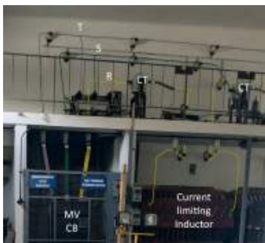
(a) Rozkład na ścianie z wyłącznikiem i dławikami
