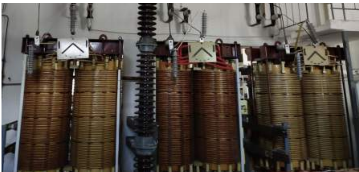
Rysunek 2.5. Transformatory probiercze typu TZNS 2000/15 EN.
